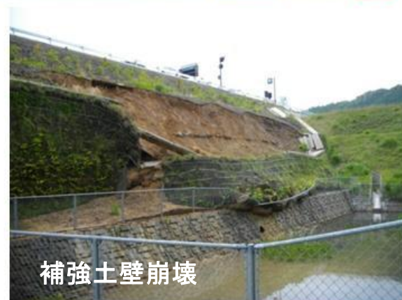
用地外のにり面崩壊
