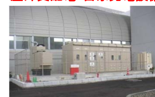
屋外受配電・自家発電設備
