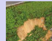
のり面崩落の状況
