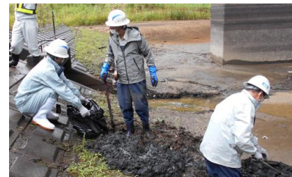
工事箇所の堆積土砂の状況の説明
