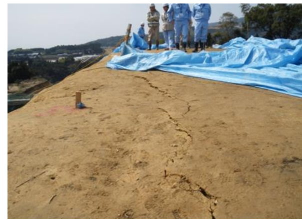
のり肩部変状状況
