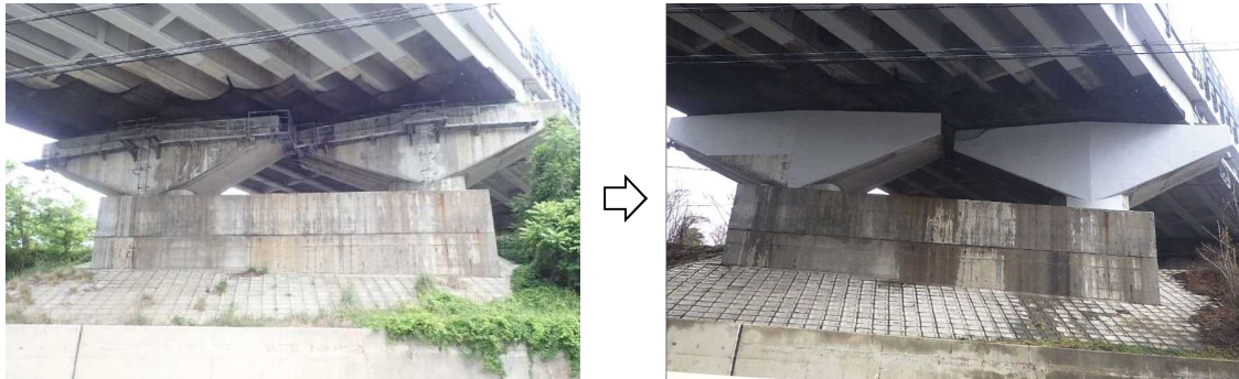
【診断結果Ⅲとされた施設の修繕事例】
