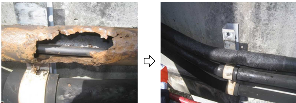
【速やかな対策が必要な変状の措置事例(ケーブル用配管の破損)】
