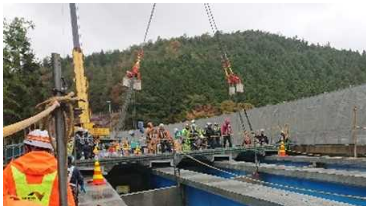
【日本初の技術(キャップスラブ工法)を採用した工事の状況】
