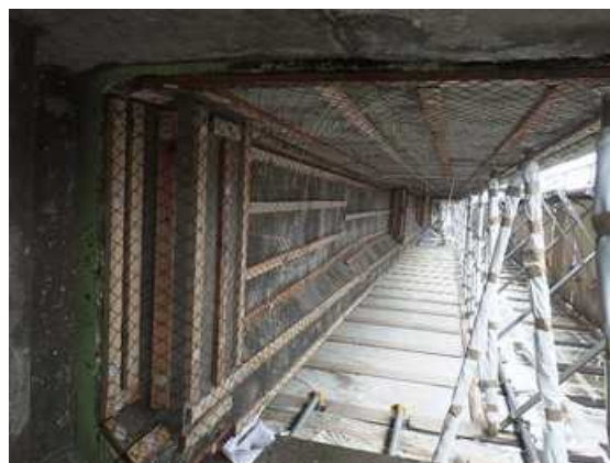
【E84 西湘バイパス(滄浪橋)の塩害対策】
