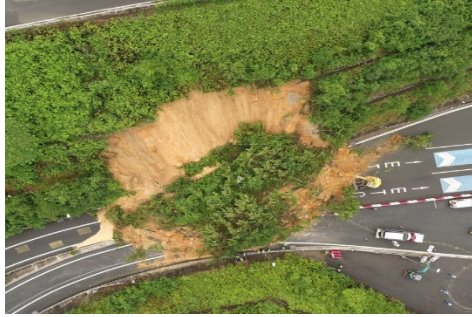
(京都縦貫道 沓掛IC付近ののり面崩落の状況)
