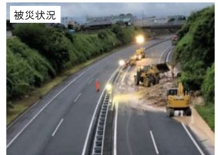
被災状況 4車線のうち、のり面崩落被害のない2車線を活用し、約8時間で下り線の通行を確保(その後、約19時間で上下線の交通機能を確保)
