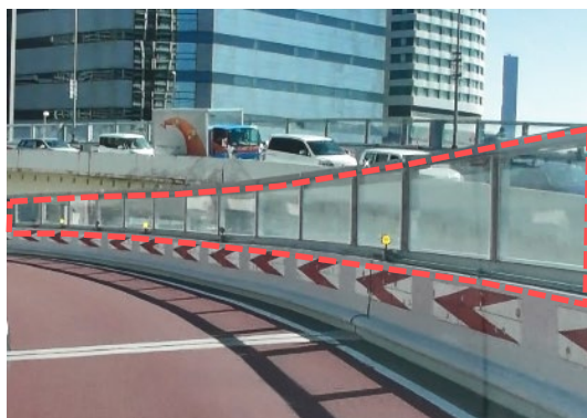
(二輪車落下防止対策の状況)
