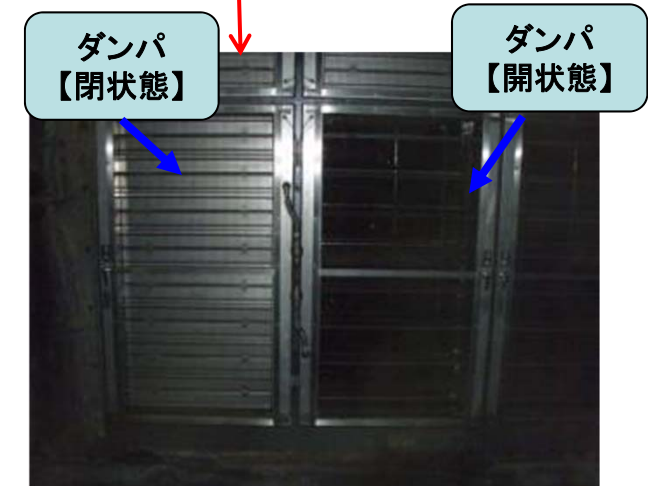
集塵ユニット
