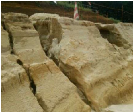
降雨後ののり面侵食状況
