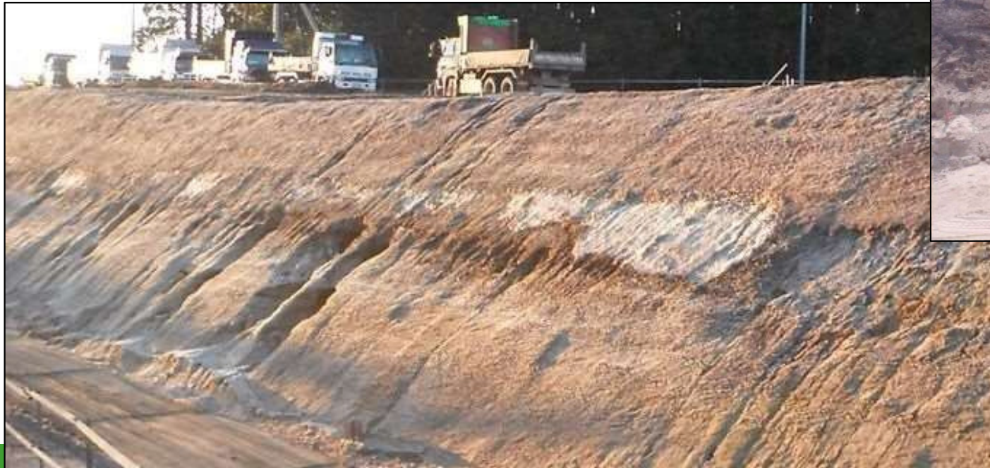
切土のり面 降雨後の侵食状況
