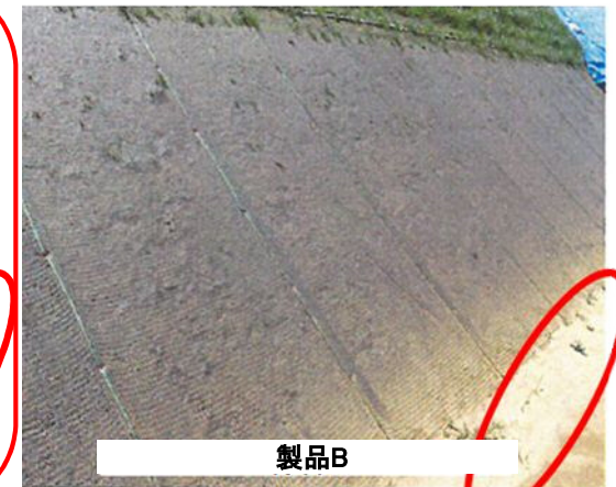
細粒土砂の流出あり
