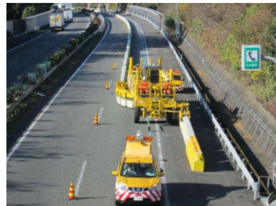
移動式防護柵移動状況
