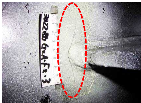
補修前（鋼桁の疲労き裂）
