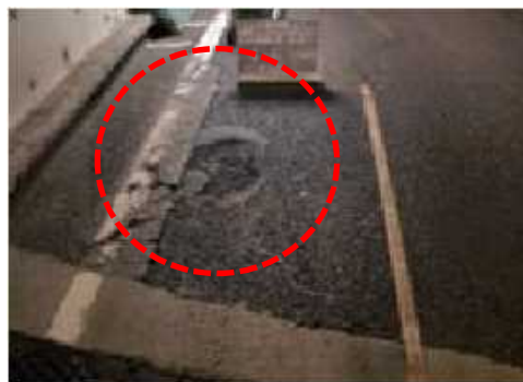
補修前（舗装の穴）
