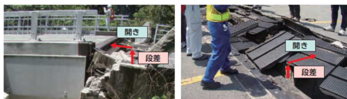
橋梁損傷事例
