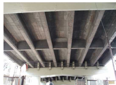
補修前（コンクリートのひび割れ）
