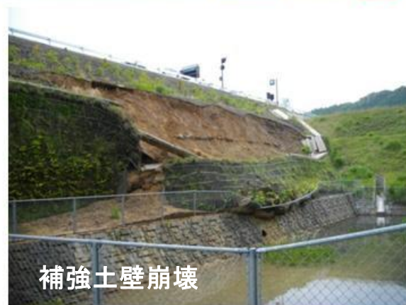
用地外のにり面崩壊
