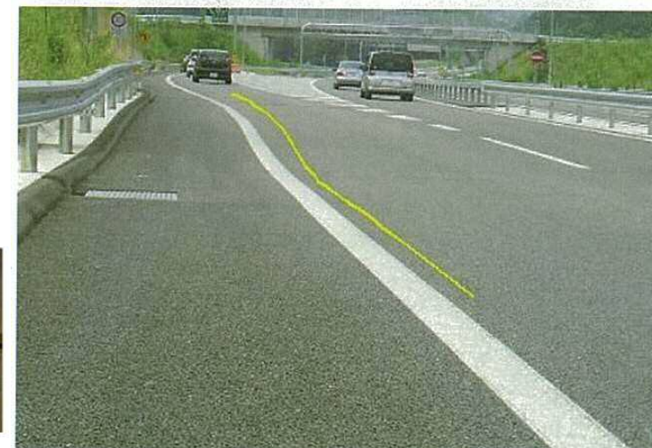
路面の沈下状況例(紀勢道)
