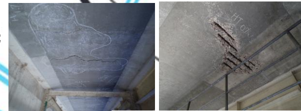
床版損傷状況
