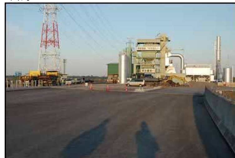
仮設プラント
